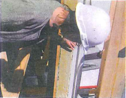
Sur le toit, une lame d'air entre la structure accueillant les panneaux photovoltaïques et les couches d'isolation (pare-vapeur, laine de roche) participe à la ventilation naturelle expérimentale. La cheminée solaire permettra de rafraîchir la grande salle du centre de loisirs et d'augmenter le rendement des capteurs solaires photovoltaïques.
